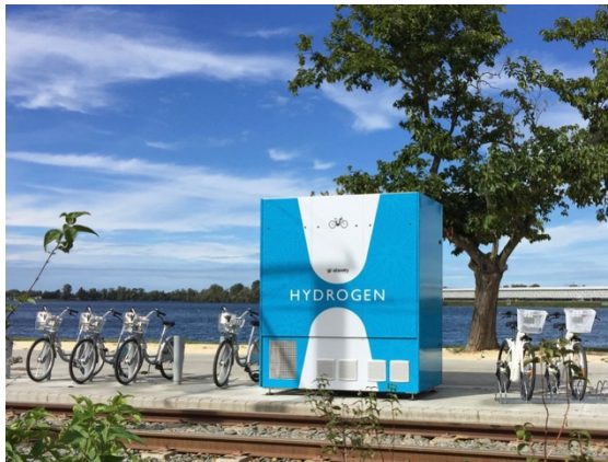
Stations de production + distribution d'hydrogène
