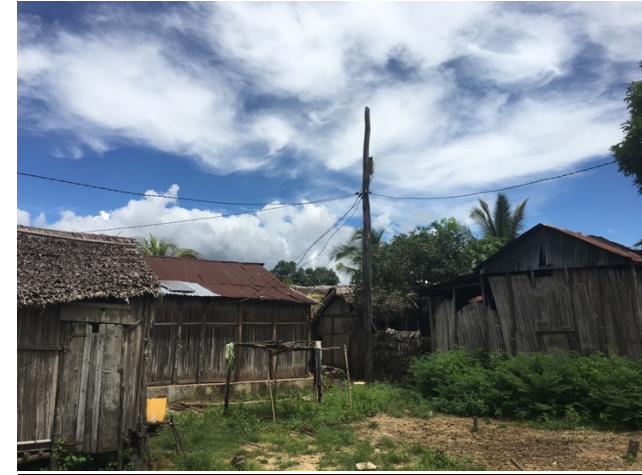
Figure 18 - Nano réseau avec le contrôleur en haut du poteau de distribution et les câbles raccordés au panneau PV, à la batterie et aux habitations
