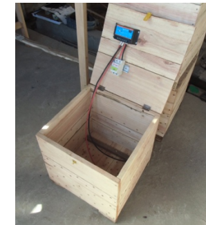
Figure 16- Coffres en bois fabriqués localement servent à accueillir les batteries
