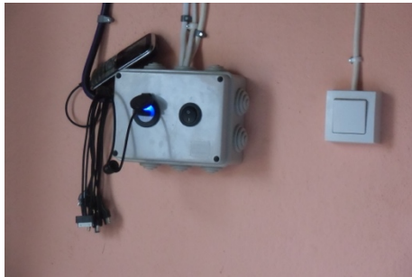
Figure 6 – Exemple de prise pour téléphone mobile sur une installation de niveau 1
